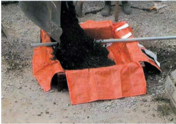
1) D・BOXを専用型枠にセットし 上部より中詰材料を投入
