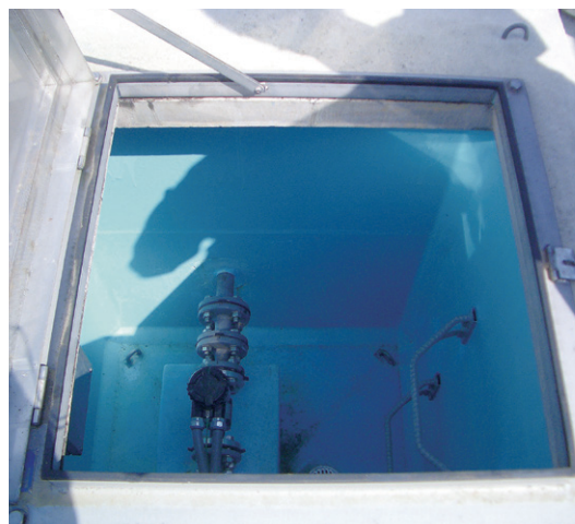
次亜塩素素注入ピット
