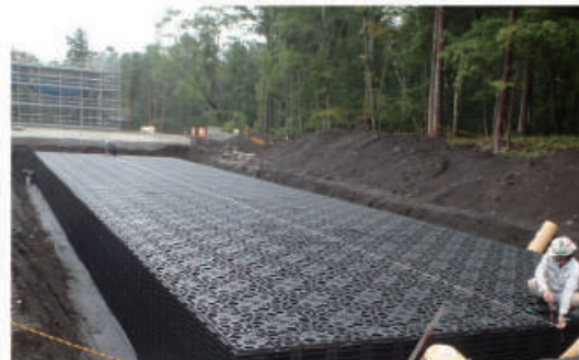
▲ 工場施設/普通車駐車場下設置
