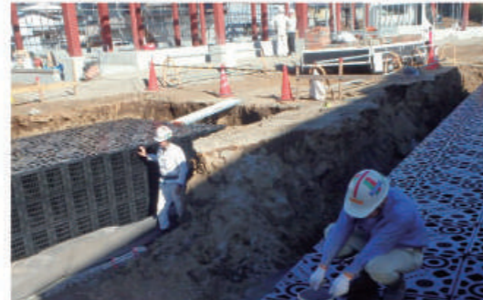
▲ 福祉施設/駐車場下・緑地下設置
