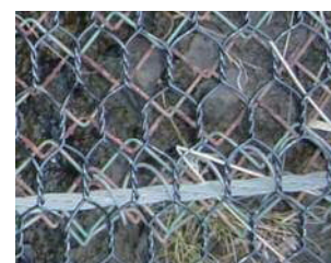
錆びた落石防止金網を撤去せず、STKネットでも更新
