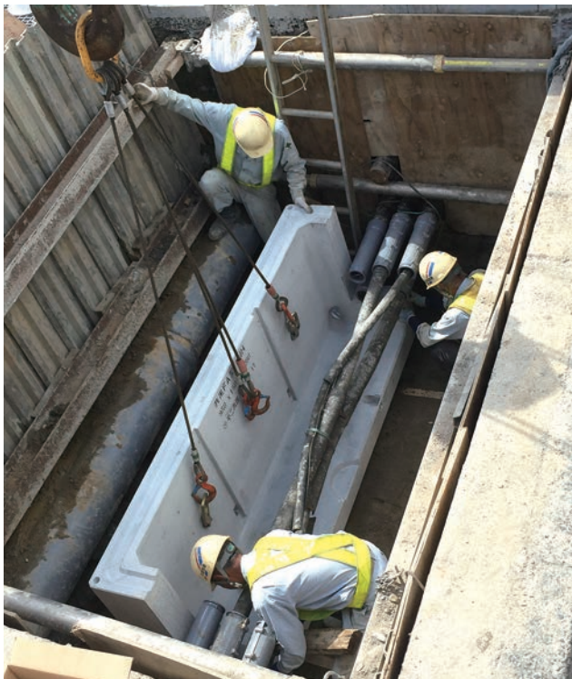
■ 福岡県 既設ケーブル抱込み用マンホール
