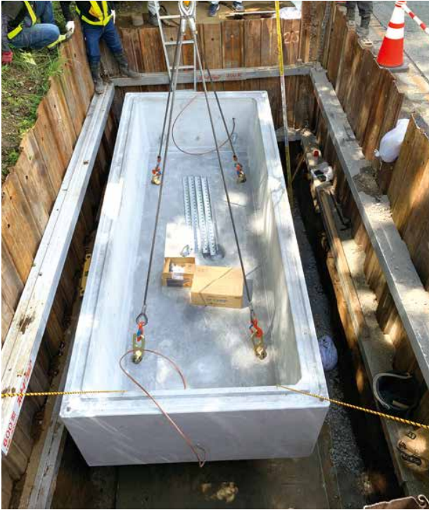
熊本県 太陽光発電所自営線マンホール
